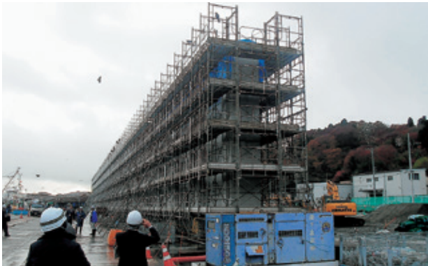
宮古市鎌ヶ崎地区の防潮堤工事。高さ10.4mで直立型の防潮堤（11月10日）
