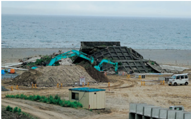
田野畑村明戸海岸の破壊された旧防潮堤（6月9日）
