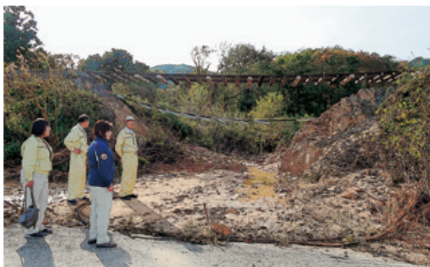
三陸鉄道の路盤が流出し線路が宙ぶり状態に。山田町にて（10月20日）
