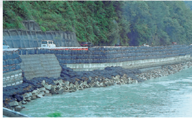
宮古市墓目の国道106号線道路崩落現場（9月23日）
