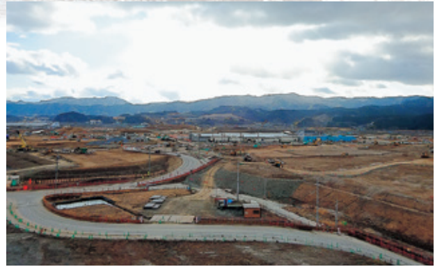
土地区画整理事業が行われている高田地区。下和野災害公営住宅屋上から撮影（2月8日）
