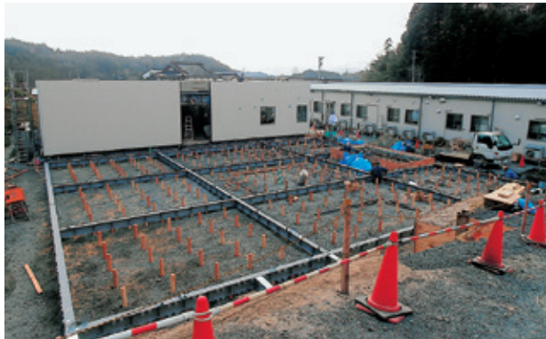
高田病院仮設診療所に整備される入院病床棟の建設現場
